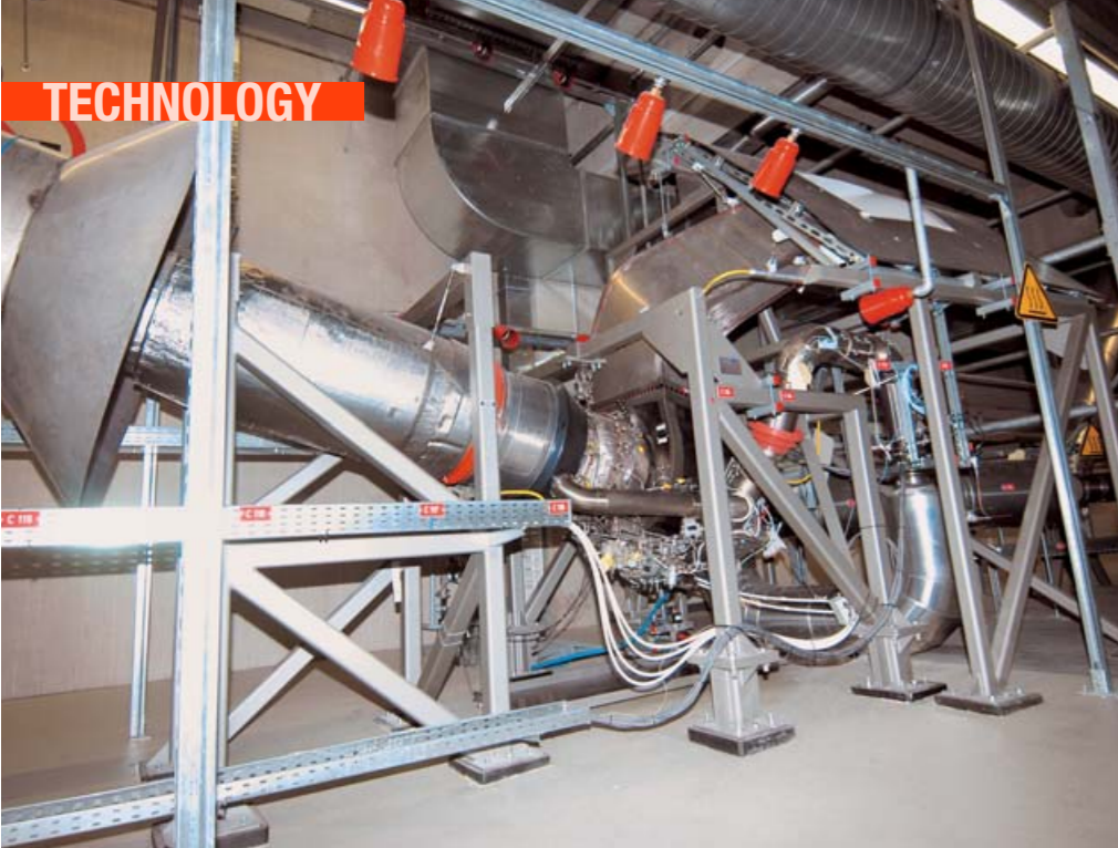
In einem Nebenraum ist die APU mit dem Bleed Air-System der A380 samt allen dazugehörigen Rohren und Ventilen aufgebaut
