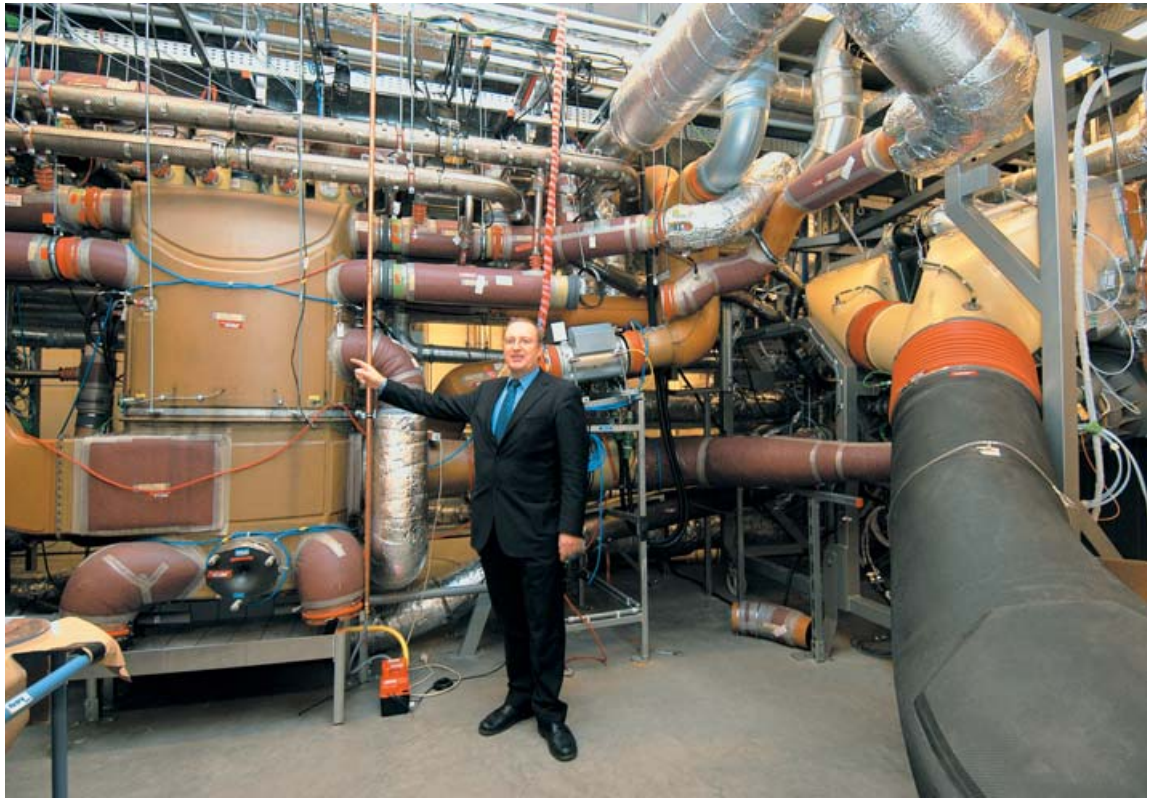
Dr. Rainer Casdorff, Leiter des Cabin Test Center, vor dem beeindruckenden Herzstück des A380-Air-Conditioning-Systems: Hier wird die „Bleed Air“ aus den Triebwerken gekühlt und mit aufbereiteter Luft aus den Hochleistungsfiltern gemischt
